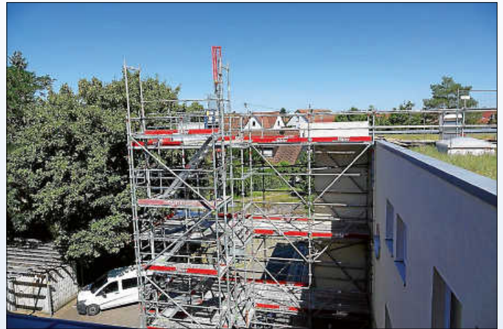
Der Zugang von außen stellt sicher, dass auch in Corona-Zeiten gebaut werden darf
