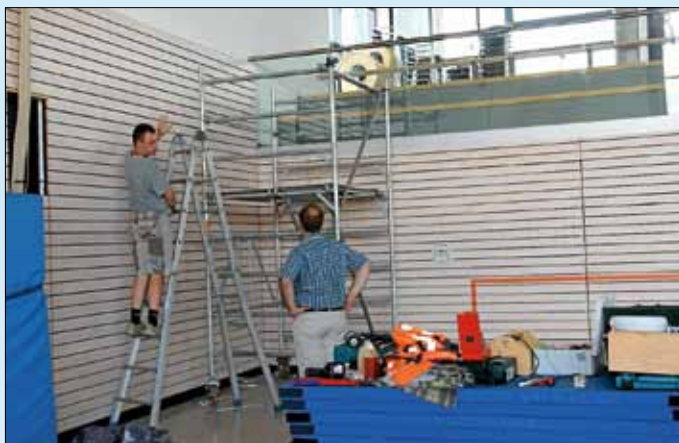
Bürgermeister Otto Ruppener begutachtet das neue Geländer. Die Schreiner des gemeindlichen Bauhofs bringen die Holzverschalung, die bei der Montage des Glasgeländers teilweise entfernt werden musste, wieder an.
