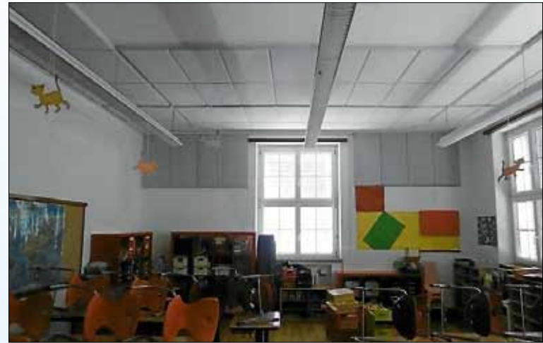
Akustikplatten in Klassenzimmern der Mörikeschule.
